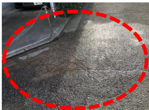
〈 工事前:広範囲に水が染み出しています 〉
